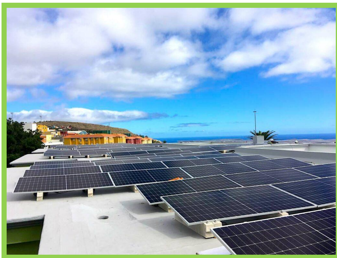
Instalación comunitaria sobre la cubierta de un centro educativo. Fuente: energiabonita.coop
