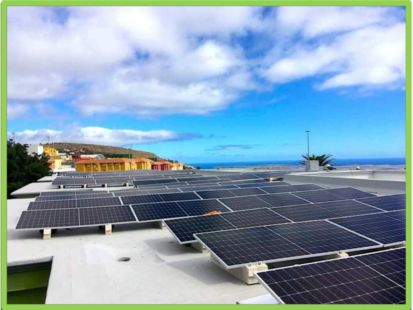
Instalación comunitaria sobre la cubierta del CEIP Manuel Galván de las Casas. Fuente: energiabonita.coop
