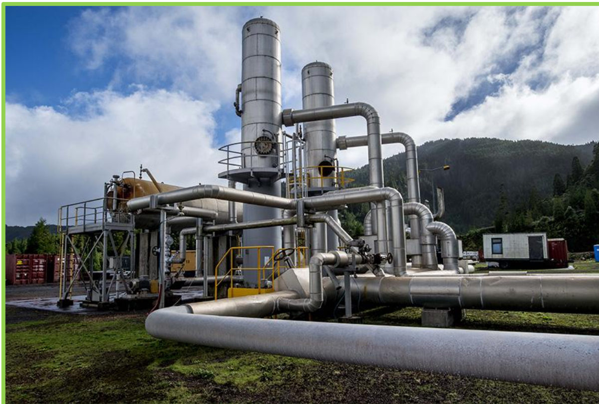
Central Geotérmica da Ribeira Grande, São Miguel, Azores. Fuente: siaram.azores.gov.pt/
